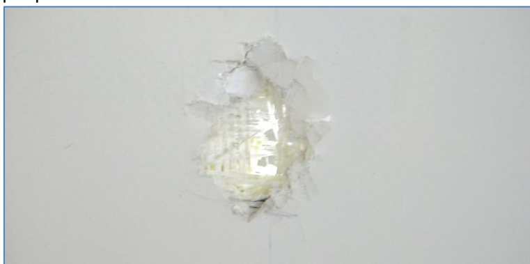
Image des dégâts : Plaque sandwich percée
