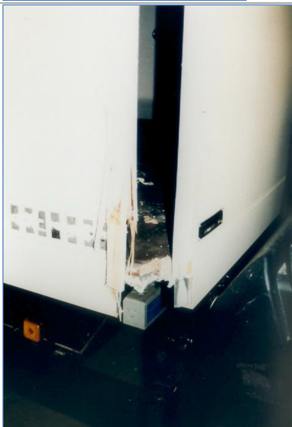
colonne d'angle endommagée démontée
